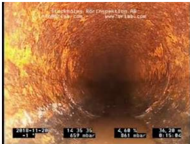
Bildnamn: 2_17_A, Videotid: 903s Ytskada 3. Rostangrepp i gjutjärn.
