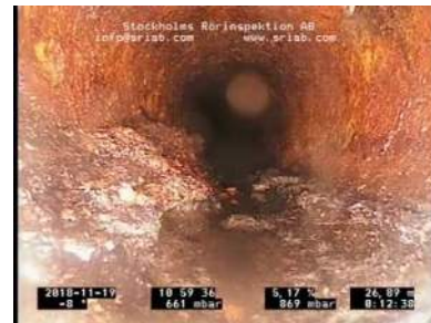
Bildnamn: 3_13_A, Videotid: 758s Främmande föremål 2. Reduktion av rörets tvärsnittsarea som är från 5 % och upp till 15 %.
