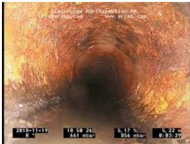
Bildnamn: 3_2_A, Videotid: 209s Ytskada 2. Mindre rostangrepp i gjutjärn.
