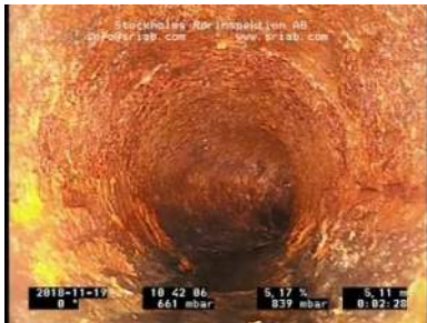
Bildnamn: 1_3_A, Videotid: 148s Ytskada 3. Rostangrepp i gjutjärn.
