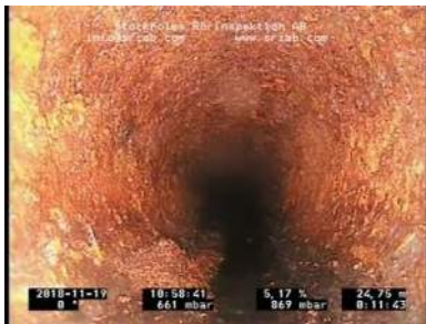
Bildnamn: 3_12_B, Videotid: 686s Ytskada 3. Rostangrepp i gjutjärn.
