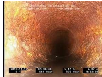
Bildnamn: 4_3_A, Videotid: 170s Ytskada 3. Rostangrepp i gjutjärn.
