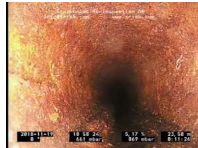
Bildnamn: 3_12_A, Videotid: 686s Ytskada 3. Rostangrepp i gjutjärn.
