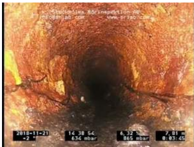
Bildnamn: 1_4_A, Videotid: 225s Påbyggnad 2. Reduktion av rörets tvärsnittsarea som är från 5% och upp till 15%.
