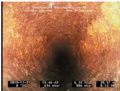
Bildnamn: 2_8_A, Videotid: 749s Ytskada 3. Rostangrepp i gjutjärn.
