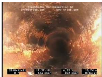
Bildnamn: 4_5_A, Videotid: 384s Ytskada 2. Mindre rostangrepp i gjutjärn.
