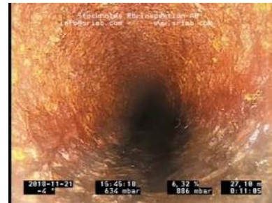
Bildnamn: 2_6_A, Videotid: 665s Ytskada 3. Rostangrepp i gjutjärn.
