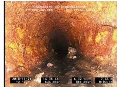
Bildnamn: 1_3_A, Videotid: 217s Ytskada 3. Rostangrepp i gjutjärn.
