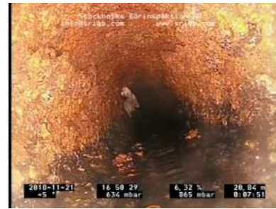
Bildnamn: 3_10_A, Videotid: 471s Ytskada 3. Rostangrepp i gjutjärn.
