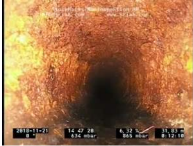
Bildnamn: 1_11_A, Videotid: 730s Ytskada 3. Rostangrepp i gjutjärn.
