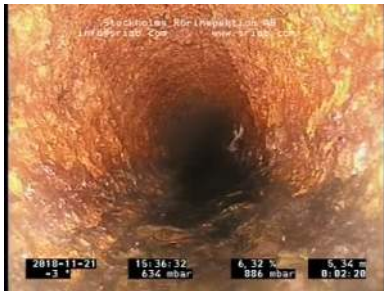
Bildnamn: 2_2_A, Videotid: 140s Ytskada 3. Rostangrepp i gjutjärn.
