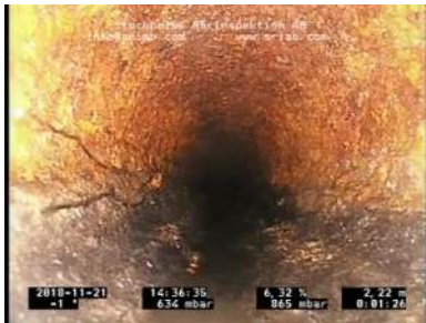
Bildnamn: 1_2_A, Videotid: 86s Ytskada 3. Rostangrepp i gjutjärn.
