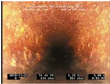
Bildnamn: 3_4_A, Videotid: 122s Ytskada 3. Rostangrepp i gjutjärn.
