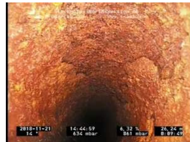
Bildnamn: 1_7_A, Videotid: 589s Ytskada 3. Rostangrepp i gjutjärn.
