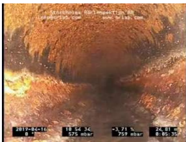
Bildnamn: 8_7_A, Videotid: 335s Ytskada 2. Mindre rostangrepp i gjutjärn.
