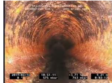
Bildnamn: 8_4_A, Videotid: 132s Ytskada 2. Mindre rostangrepp i gjutjärn.
