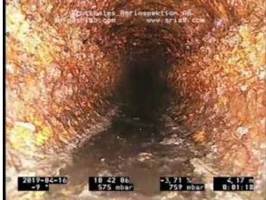
Bildnamn: 7_2_A, Videotid: 78s Ytskada 3. Rostangrepp i gjutjärn.
