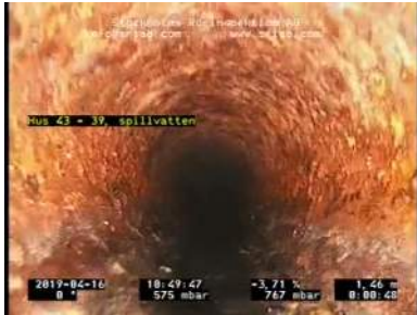
Bildnamn: 8_3_A, Videotid: 48s Ytskada 3. Rostangrepp i gjutjärn.
