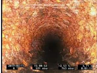
Bildnamn: 6_2_A, Videotid: 71s Ytskada 3. Rostangrepp i gjutjärn.
