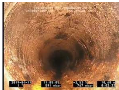
Bildnamn: 1_6_A, Videotid: 142s Ytskada 2. Rörväggen är synligt påverkad med ökad ytråhet som följd, klockan 12-12.
