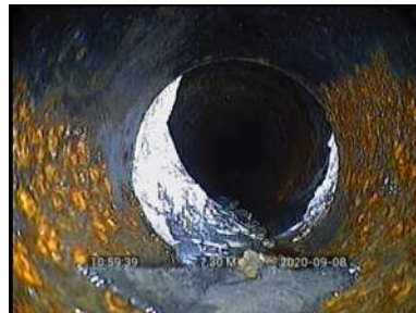
Bildnamn: 5_5_A, Videotid: 93s Främmande föremål 3. Reduktion av rörets tvärsnittsarea som är från 15 % och upp till 30 %.
