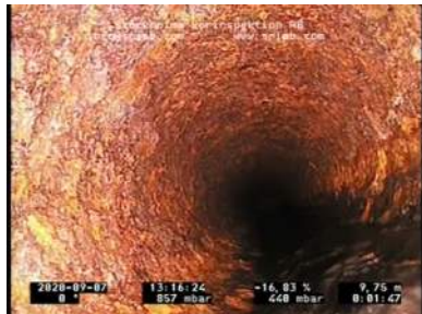
Bildnamn: 2_2_A, Videotid: 107s Ytskada 3. Rostangrepp i gjutjärn.
