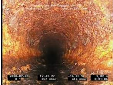
Bildnamn: 1_3_A, Videotid: 66s Ytskada 3. Rostangrepp i gjutjärn.
