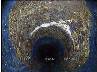
Bildnamn: 7_3_B, Videotid: 103s Ytskada 2. Mindre rostangrepp i gjutjärn.
