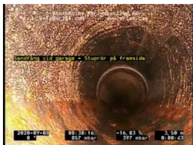
Bildnamn: 3_2_A, Videotid: 43s Ytskada 2. Mindre rostangrepp i gjutjärn.
