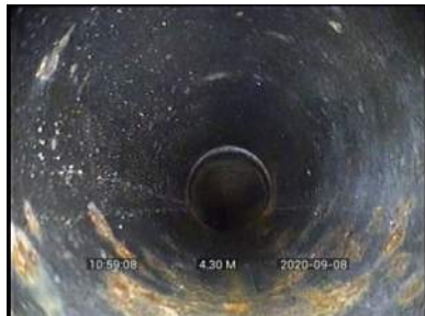
Bildnamn: 5_4_A, Videotid: 62s Ytskada 2. Mindre rostangrepp i gjutjärn.
