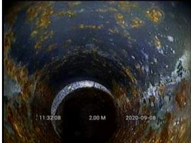
Bildnamn: 6_4_A, Videotid: 23s Ytskada 2. Mindre rostangrepp i gjutjärn.
