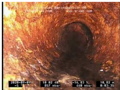
Bildnamn: 3_4_A, Videotid: 215s Ytskada 3. Rostangrepp i gjutjärn.
