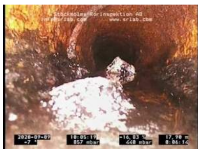
Bildnamn: 3_9_B, Videotid: 386s Främmande föremål 2. Reduktion av rörets tvärsnittsarea som är från 5 % och upp till 15 %.
