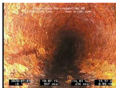
Bildnamn: 3_10_A, Videotid: 490s Ytskada 3. Rostangrepp i gjutjärn.
