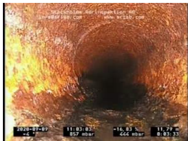
Bildnamn: 4_6_A, Videotid: 213s Ytskada 3. Rostangrepp i gjutjärn.
