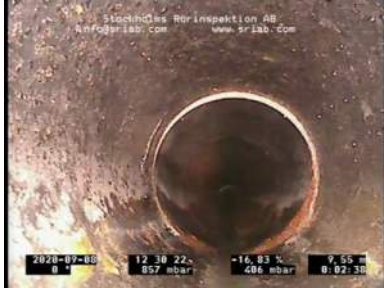
Bildnamn: 1_5_A, Videotid: 158s Ytskada 2. Mindre rostangrepp i gjutjärn.
