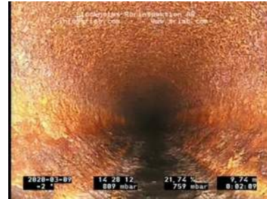
Bildnamn: 2_8_A, Videotid: 129s Ytskada 3. Rostangrepp i gjutjärn.
