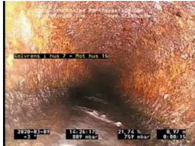
Bildnamn: 2_2_A, Videotid: 11s Vattenansamling 2. Medför en vattennivå som är från 5 % och upp till 15 % av rörets invändiga höjd, börjar .
