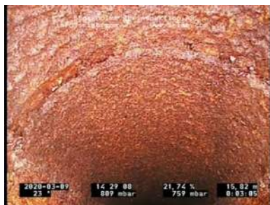
Bildnamn: 2_10_A, Videotid: 185s Ytskada 3. Rostangrepp i gjutjärn.
