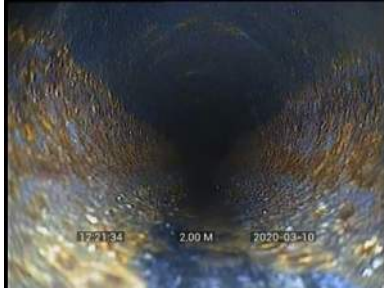
Bildnamn: 7_3_A, Videotid: 34s Ytskada 2. Mindre rostangrepp i gjutjärn.
