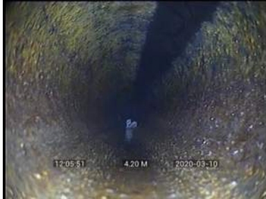
Bildnamn: 5_5_A, Videotid: 50s Ytskada 2. Mindre rostangrepp i gjutjärn.
