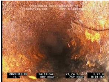
Bildnamn: 1_2_A, Videotid: 62s Ytskada 3. Rostangrepp i gjutjärn.
