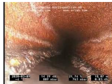
Bildnamn: 2_12_A, Videotid: 225s Vattenansamling 1. Medför en vattennivå som är mindre än 5 % av rörets invändiga höjd, börjar .
