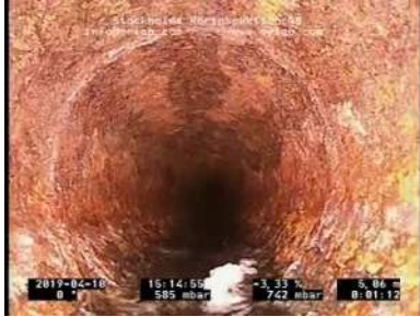
Bildnamn: 3_3_A, Videotid: 72s Ytskada 3. Rostangrepp i gjutjärn.
