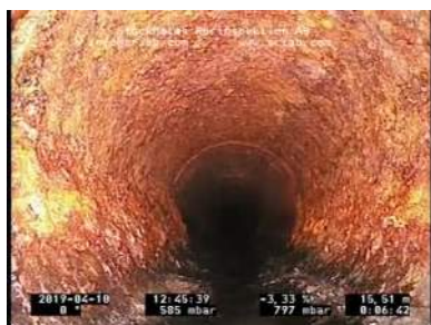
Bildnamn: 1_6_A, Videotid: 402s Utfällning/Påväxt 1. Reduktionen av tvärsnittsarean är 5 % eller mindre, utfällning.
