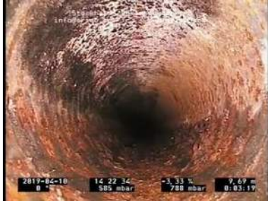
Bildnamn: 5_4_A, Videotid: 199s Ytskada 2. Mindre rostangrepp i gjutjärn.
