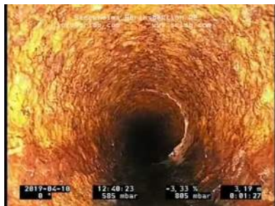
Bildnamn: 1_4_A, Videotid: 87s Ytskada 3. Rostangrepp i gjutjärn.
