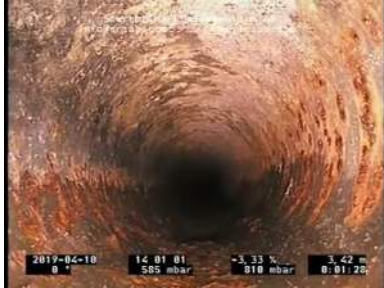
Bildnamn: 4_2_A, Videotid: 88s Ytskada 2. Mindre rostangrepp i gjutjärn.
