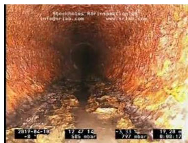
Bildnamn: 1_10_A, Videotid: 497s Främmande föremål 2. Reduktion av rörets tvärsnittsarea som är från 5 % och upp till 15 %.
