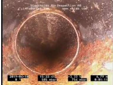
Bildnamn: 6_4_A, Videotid: 71s Ytskada 2. Mindre rostangrepp i gjutjärn.
