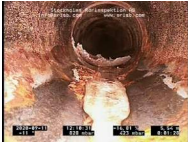
Bildnamn: 2_2_A, Videotid: 88s Främmande föremål 2. Reduktion av rörets tvärsnittsarea som är från 5 % och upp till 15 %.
