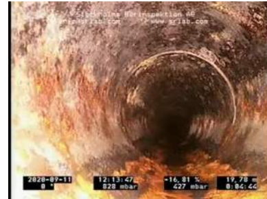
Bildnamn: 2_6_A, Videotid: 284s Ytskada 2. Mindre rostangrepp i gjutjärn.
