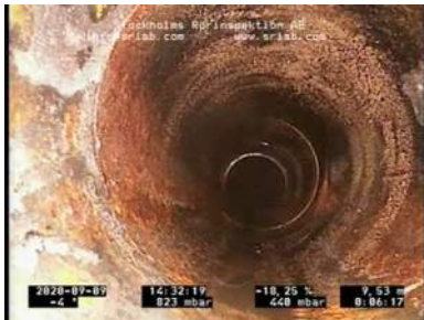
Bildnamn: 1_5_A, Videotid: 377s Ytskada 2. Mindre rostangrepp i gjutjärn.
