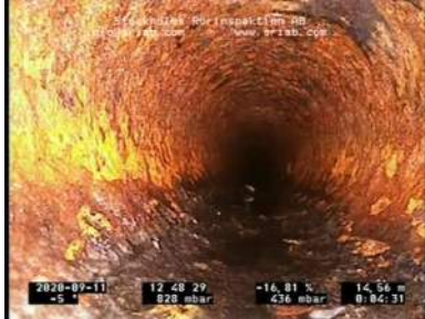
Bildnamn: 3_7_A, Videotid: 271s Ytskada 3. Rostangrepp i gjutjärn.
