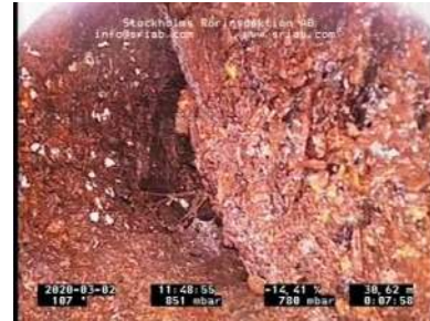
Bildnamn: 2_14_A, Videotid: 479s Sediment 4. Reduktion av rörets tvärsnittsarea som är från 30% eller större, hårt eller packat material.
