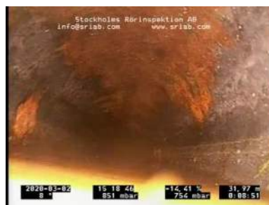
Bildnamn: 3_15_A, Videotid: 531s Vattenansamling 3. Medför en vattennivå som är från 15 % - 30 % av rörets invändiga höjd, börjar.
