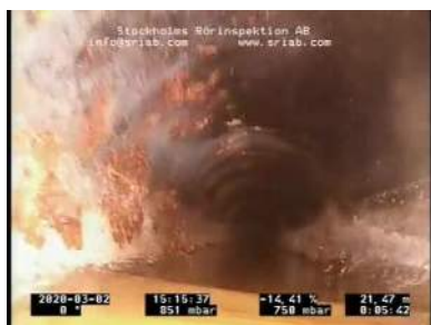
Bildnamn: 3_11_A, Videotid: 342s Vattenansamling 2. Medför en vattennivå som är från 5 % och upp till 15 % av rörets invändiga höjd, börjar.
