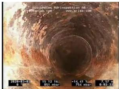
Bildnamn: 3_6_A, Videotid: 142s Ytskada 2. Mindre rostangrepp i gjutjärn.
