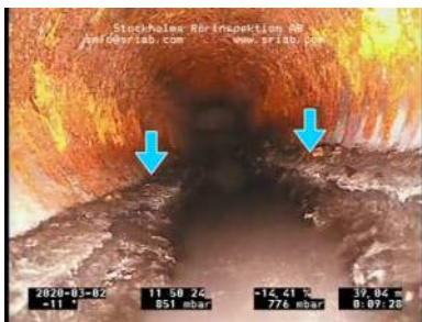
Bildnamn: 2_15_A, Videotid: 568s Utfällning/Påväxt 2. Reduktionen av tvärsnittsarean är mellan 5-15 %, utfällning.
