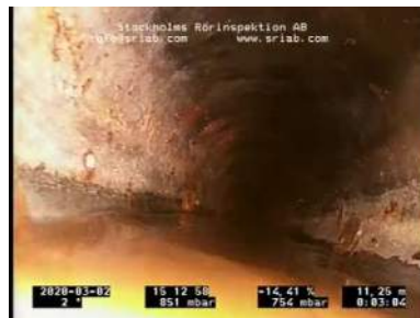
Bildnamn: 3_7_A, Videotid: 184s Vattenansamling 2. Medför en vattennivå som är från 5 % och upp till 15 % av rörets invändiga höjd, börjar.
