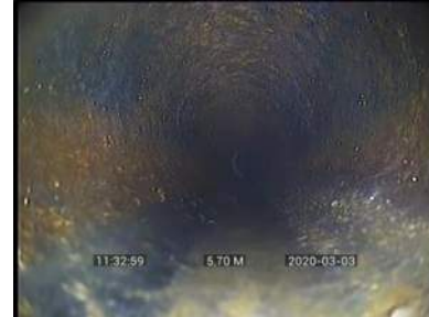
Bildnamn: 8_5_A, Videotid: 80s Ytskada 2. Mindre rostangrepp i gjutjärn.
