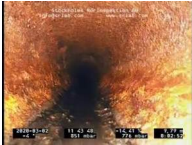
Bildnamn: 2_5_A, Videotid: 173s Ytskada 3. Rostangrepp i gjutjärn.
