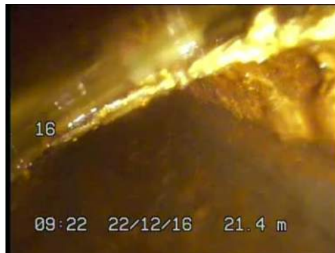
Bildnamn: 1_8_A, Videotid: 458;2529s Sediment 2. Reduktion av rörets tvärsnittsarea som är från 5% och upp till 15%, hårt eller packat material .
