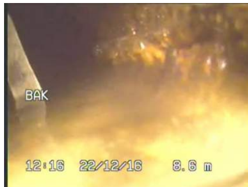
Bildnamn: 5_7_A, Videotid: 138;2533s Främmande föremål 1. Reduktion av rörets tvärsnittsarea som är mindre än 5%.
