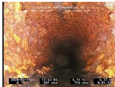
Bildnamn: 2_6_A, Videotid: 92s Ytskada 3. Rostangrepp i gjutjärn.
