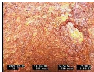
Bildnamn: 3_6_A, Videotid: 123s Ytskada 3. Rostangrepp i gjutjärn.
