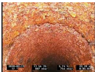
Bildnamn: 2_14_A, Videotid: 303s Ytskada 3. Rostangrepp i gjutjärn.
