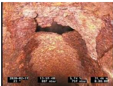
Bildnamn: 2_19_A, Videotid: 488s Rörbrott 4. På ledning i eller under byggnad, klockan 11-02.
