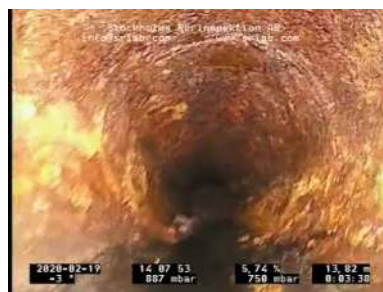
Bildnamn: 3_11_A, Videotid: 218s Ytskada 3. Rostangrepp i gjutjärn.
