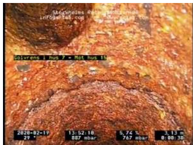
Bildnamn: 2_3_A, Videotid: 38s Ytskada 3. Rostangrepp i gjutjärn.
