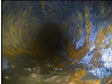
Bildnamn: 9_6_A, Videotid: 145s Ytskada 2. Mindre rostangrepp i gjutjärn.
