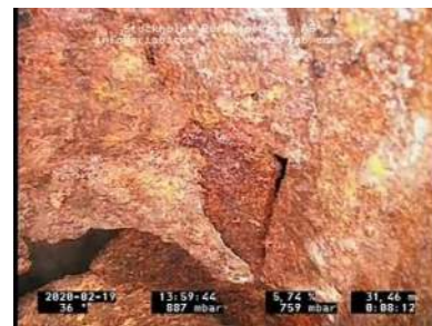
Bildnamn: 2_19_B, Videotid: 488s Rörbrott 4. På ledning i eller under byggnad, klockan 11-02.
