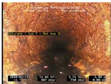
Bildnamn: 3_2_A, Videotid: 42s Ytskada 3. Rostangrepp i gjutjärn.
